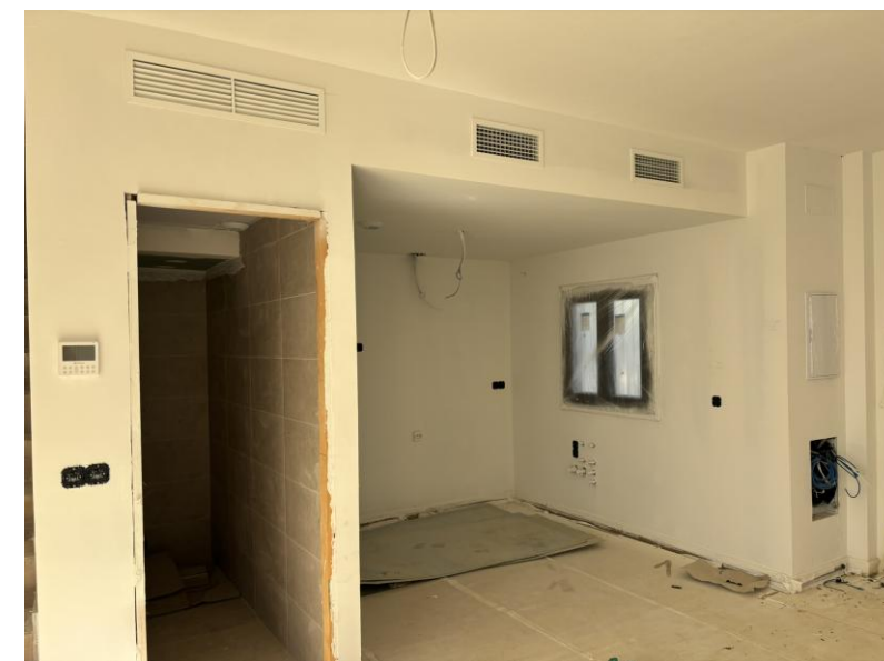
Fotografía 3. Vista cocina vivienda c/Tabarca
