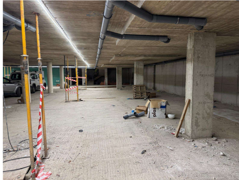
Fotografía 2. Planta sótano con instalaciones de saneamiento
