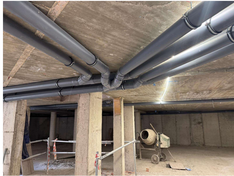
Fotografía 1. Planta sótano con instalaciones de saneamiento
