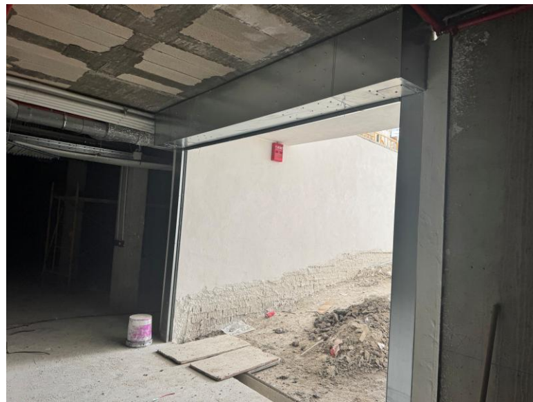
Fotografía 4. Puerta PCI Garaje
