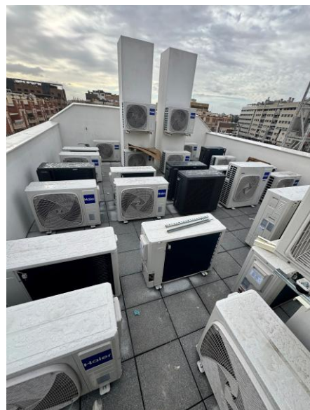
Fotografía 5. Localización unidades exteriores clima bloque 1
