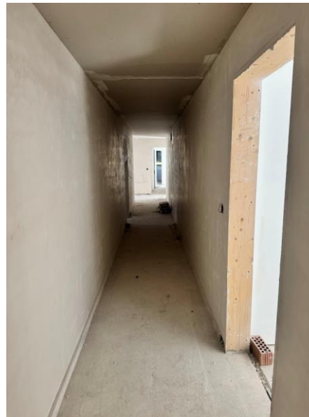
Fotografía 2. Guarnecido de yeso en Pasillo E4 (planta baja)
