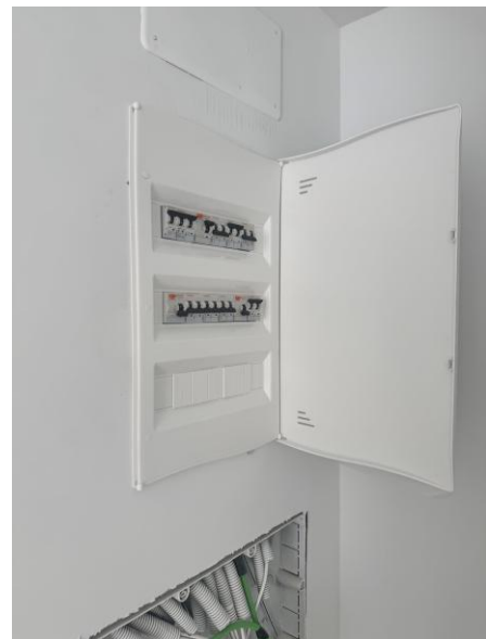
Fotografía 4. Cuadro de Mando y Protección Eléctrica equipado
